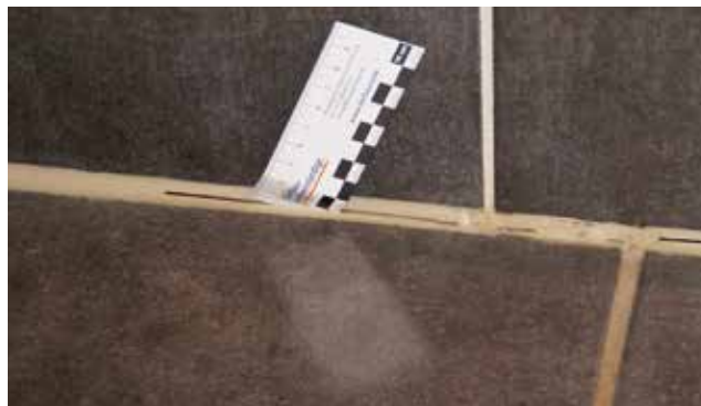
Undichte, abgerissene Silikonfugen sind oftmals die Ursache für einen Feuchteintrag in die Konstruktion.
